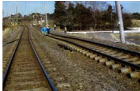
ケ.【盛土沈下(常磐線 水戸～勝田間) 復旧前
