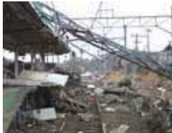
J【道床流失】 のびる (仙石線 野蒜構内)
